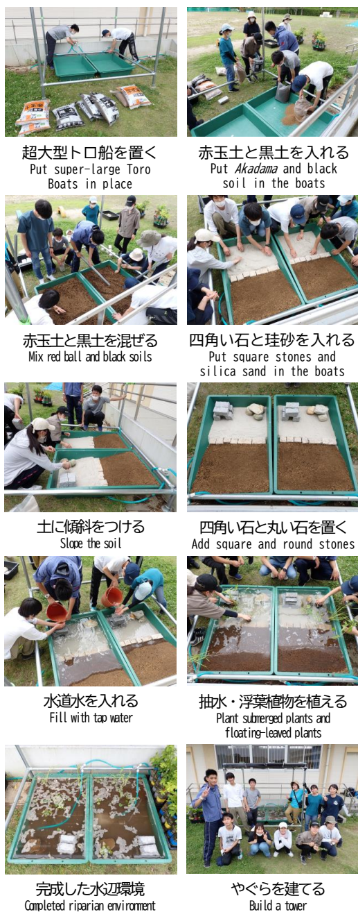
図5 簡易ビオトープの水辺環境を設置する作業風景 Figure 5 Setting up the riparian environment of the simple biotope
